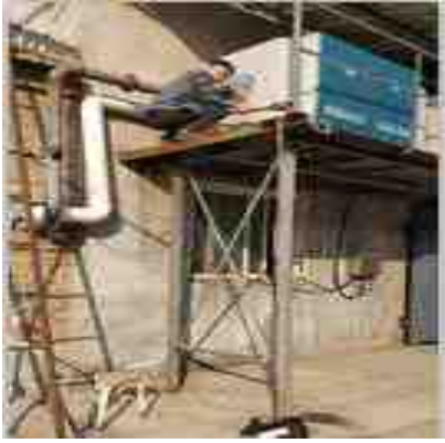
光氧设备废气进口检测
