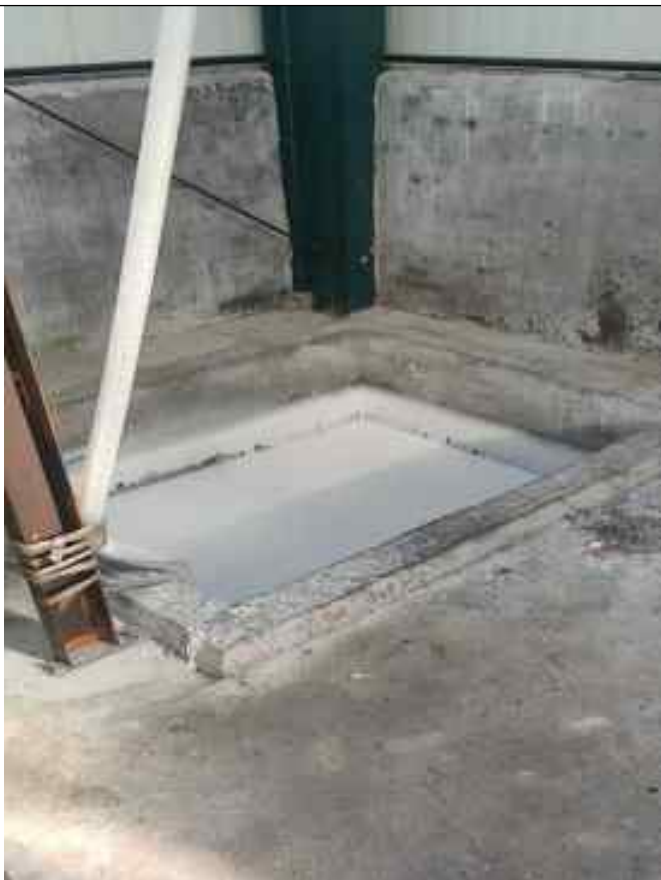
浸润剂回收池
