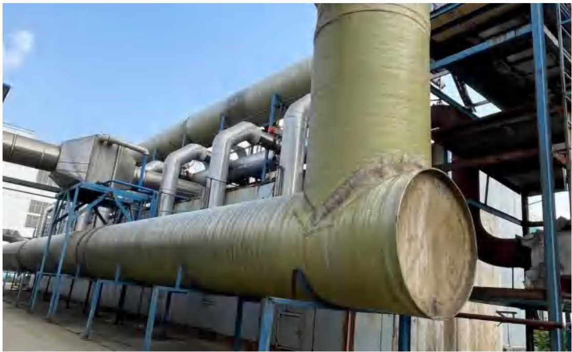
废气治理中心
