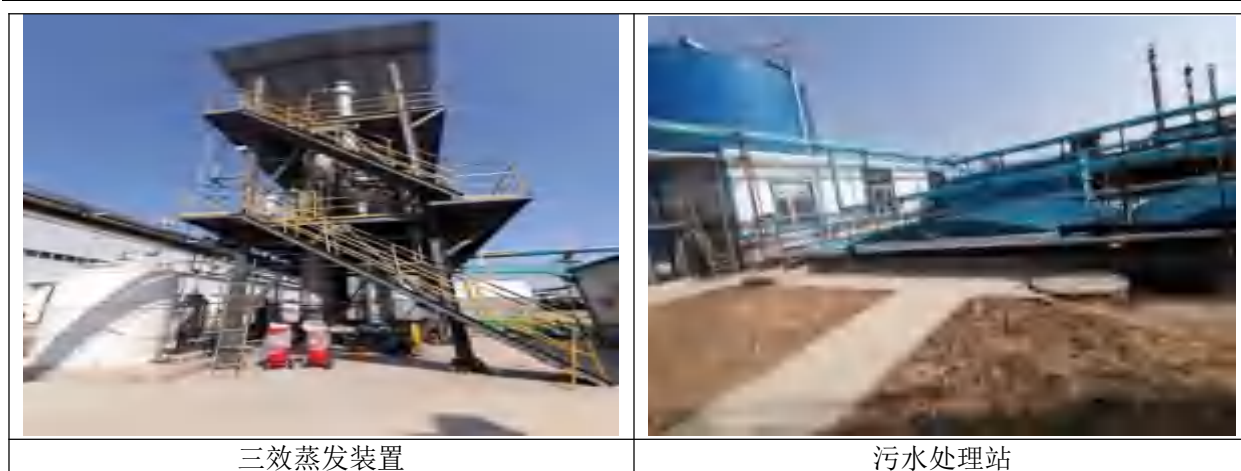
图4.1-3 废水处理设施
