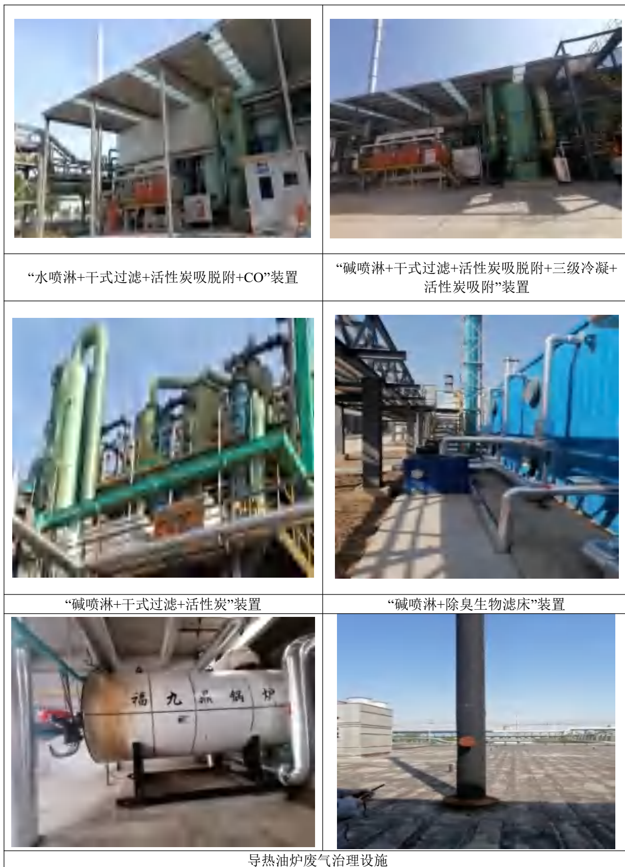
图4.1-5 废气处理设施
